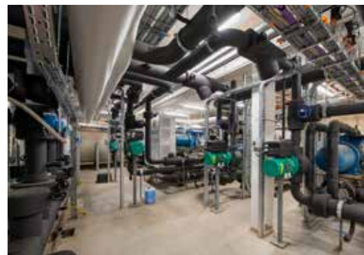
Het installatietechnische hart van het nieuwe Ommelanders Ziekenhuis Groningen
